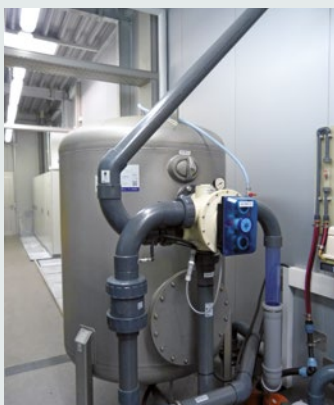
Filter und Pumpe mit frequenzgeregelter Steuerung.
